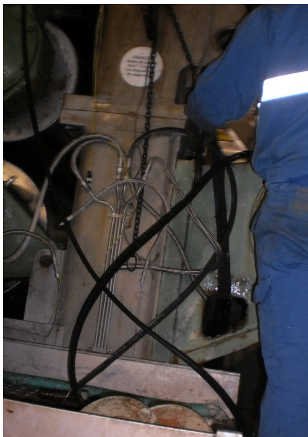
Figura 24 – Tubagens de lubrificação e de águas de refrigeração
