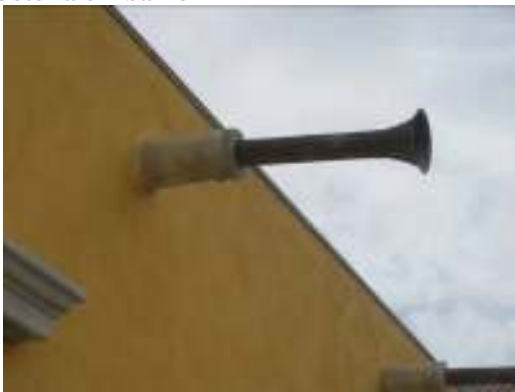
Fig.4.3.3 Goteira em pedra com ponta em ferro
