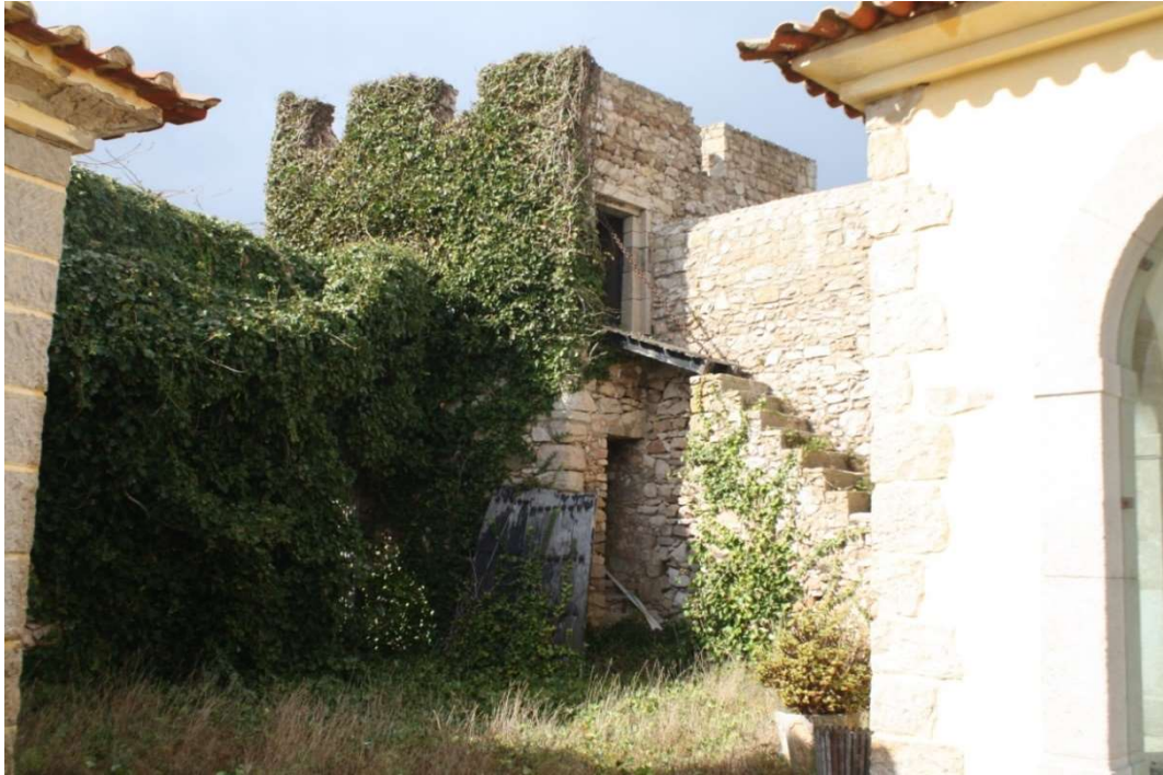
FIG. 15 – Fotografia tirada antes das obras executadas pela CM de VP – Baluarte e muralhas repleto de arbustos.
