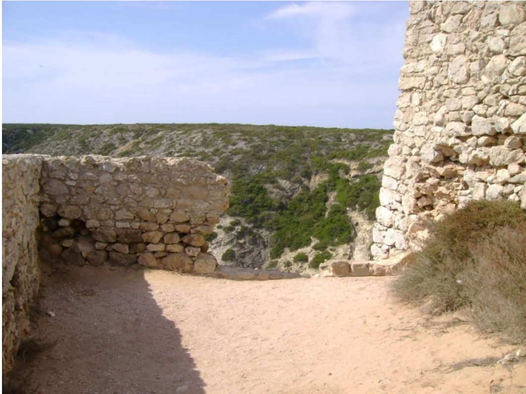
FIG. 19 – Fotografia tirada antes das obras executadas pela CM de VP – pano de muralha derrubado.
