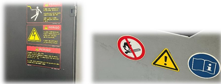
Figura 29- Sinalização de segurança (Fonte: Própria, 2025)
