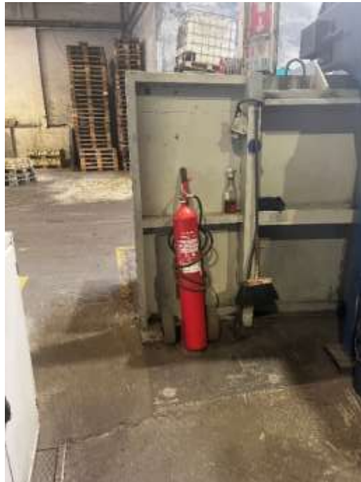
Figura 34 - Extintor (Fonte: Autora)
