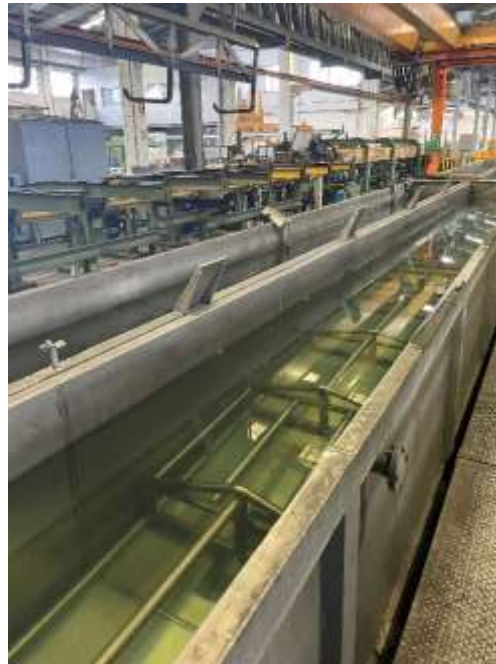
Figura 38 - Tanques de Decapagem (Fonte: Autora)
