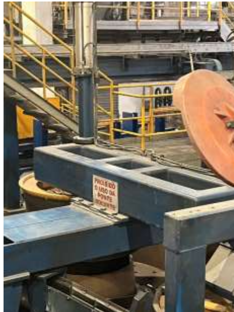
Figura 36 - Sinalização relativa à Ponte Rolante (Fonte: Autora)
