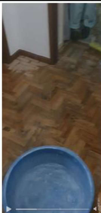
Nota: Presença de água no piso da sala da casa.
