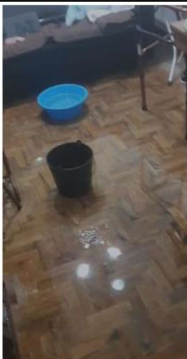
Nota: Presença de água no piso da sala da casa.
