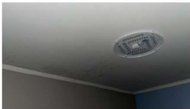
Danos na sala da casa nº 110
