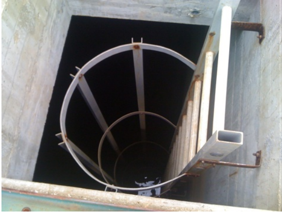
Foto 3 Caixa para tanque de equalização
