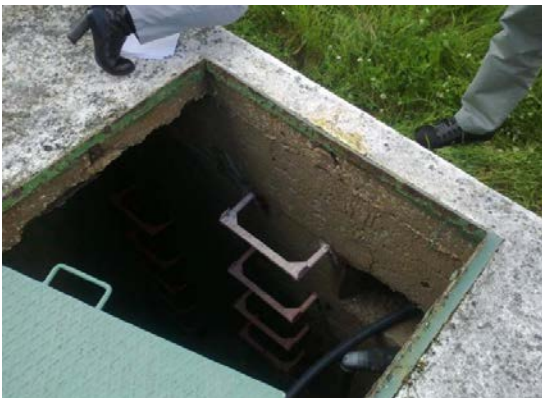
Foto 1 Caixa para injeção de cloro em conduta
