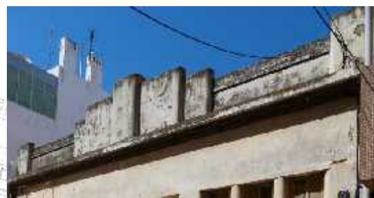
Figura 41 – Diferença de alturas na platibanda
