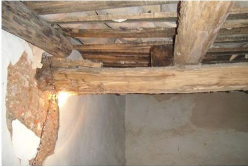
Figura 98: Estrutura de madeira deformada.
