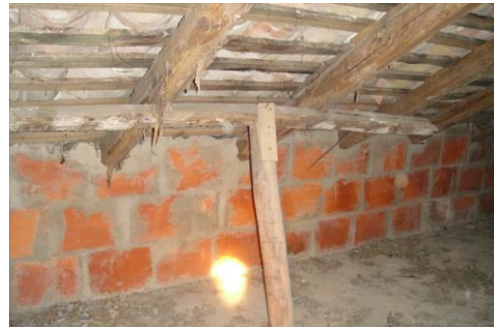
Figura 99: Incapacidade de suportar a carga da cobertura.
