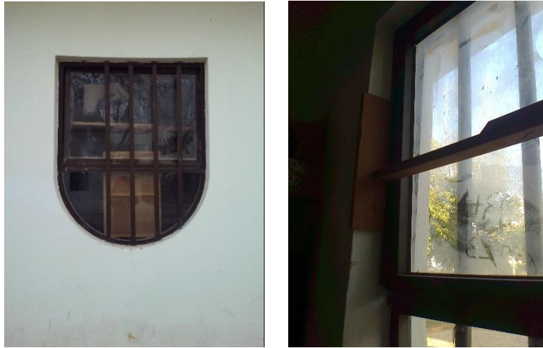
Figura 83 e 84: Janelas das catequeses danificadas.
