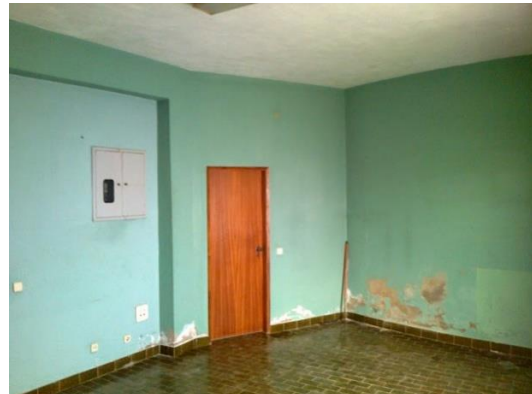
Figura 90: Humidades no espaço da Sacristia.
