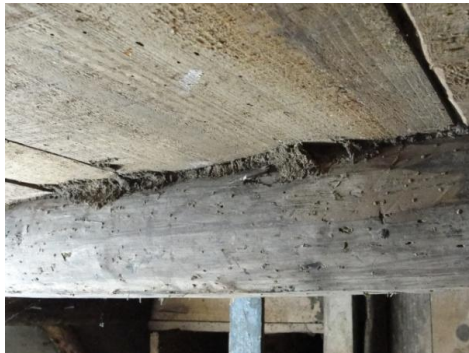
Figura 100: Viga de suporte infestada de insetos.
