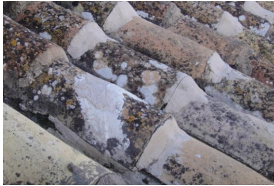
Figura 95: Telhas argamassadas e sua irregularidade.
