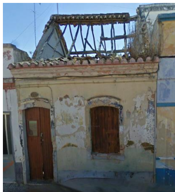
Fig. 97 - Edifício sem reabilitação, situado na Rua Dr. Sousa Martins, n.º127 - Classificação E4 de acordo com o PPS.NP.VRSA.
