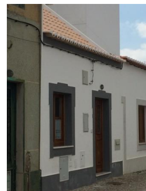
Fig. 114 - Edifícios existentes na Rua Almirante Cândido dos Reis, n.º 130 – Exemplo negativo na aplicação das caixas de infraestruturas.
